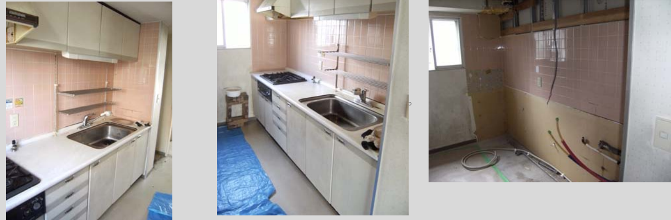
<写真の説明> ・左、中 キッチン着工前 ・既設キッチン撤去後
